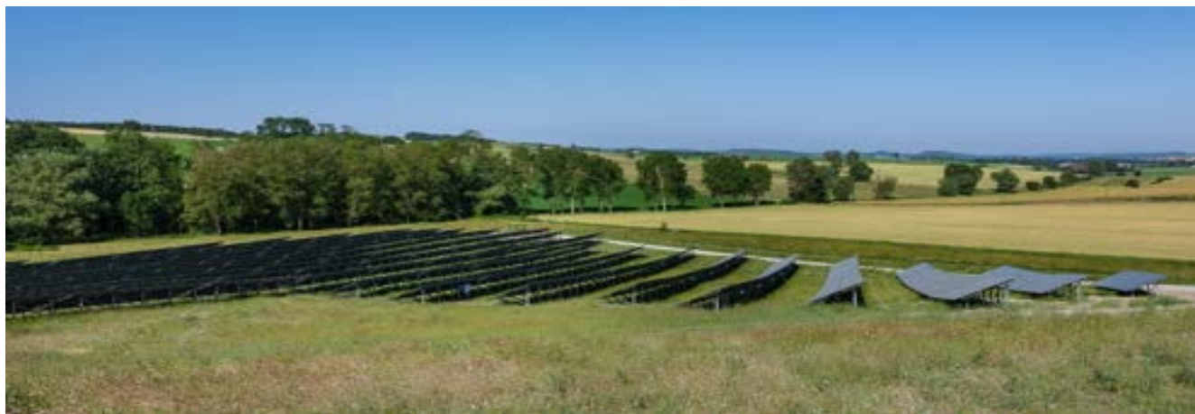
Centrale photovoltaïque de Fanjeaux (Source : ENGIE GREEN)
