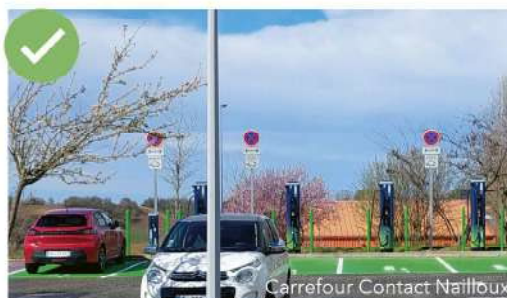
Bornes de recharge pour voitures à moteurs électriques
